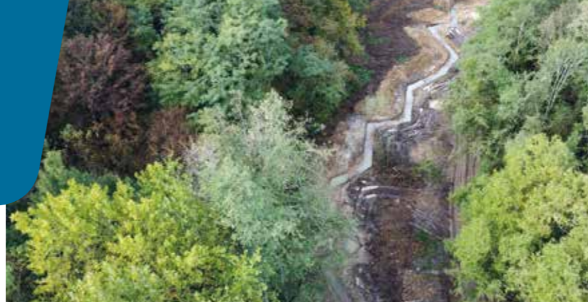
Un exemple d'expérimentation : Mise sous contrainte de la rivière par un tracé avec angles-droits, de manière à la forcer à adapter son transport sédimentaire, dans le cadre d'une restauration du lit et d'une remise en fond de vallée. (Torchaize - 2023 - Site de Gaudent)
