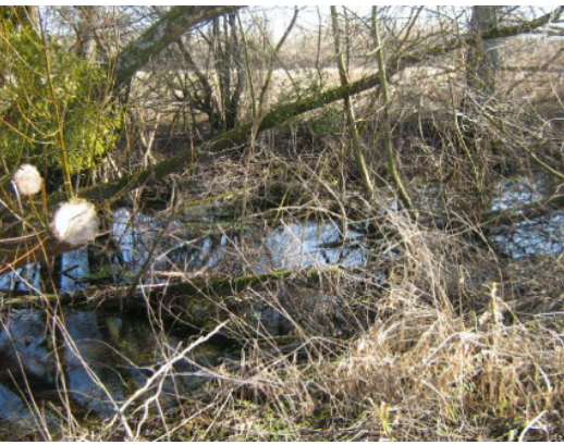
Annexe hydraulique encombrée avant les travaux
