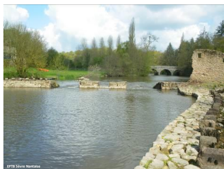
Brèche sur une chaussée
