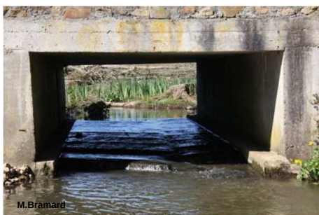
OH sous-dimensionné (vide d'air faible) équipé de barrettes
