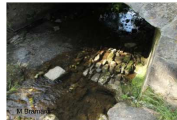
radier de pont commençant à se dégrader
