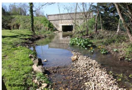
recharge dans la fosse de dissipation
