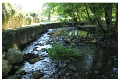
OH* avec faibles contraintes latérales (1 seul bajoyer), la recharge reste en place
