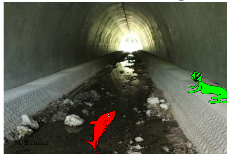
Sédiments arrachés étalés dans la portion aval de l'OH
