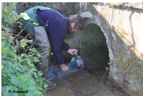
M Bramard destruction d'une rehausse mal positionnée
