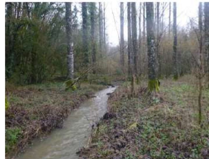
Ruisseau de la Torchaise en partie amont, en fond de vallée suite aux brèches sur le lit perché
