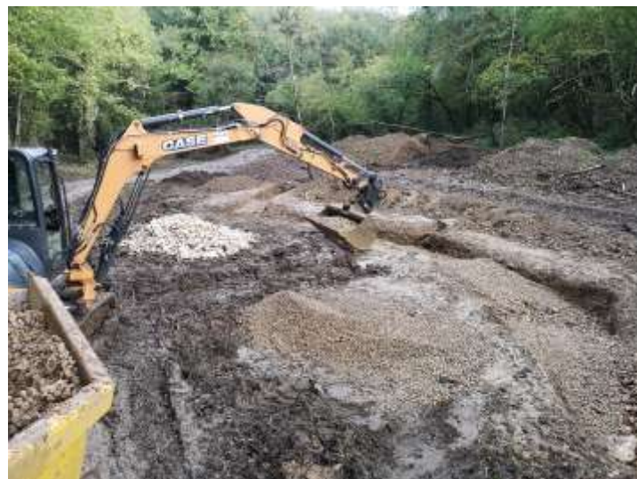
Mauvaise étendue granulométrique des matériaux utilisés pour aménager les radiers
