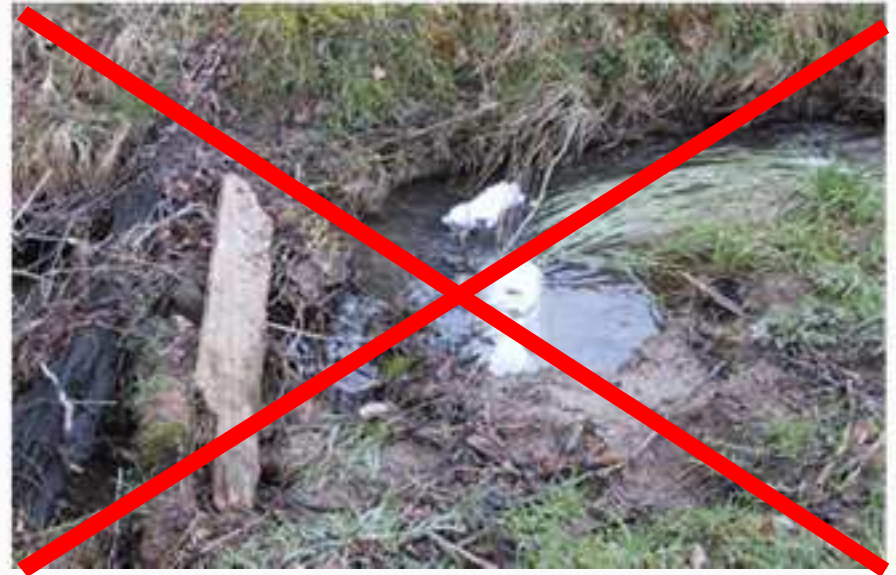
Ouvrage non pérenne, pas de partition
